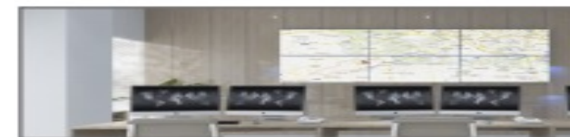
Trung tâm điều hành PCCC
